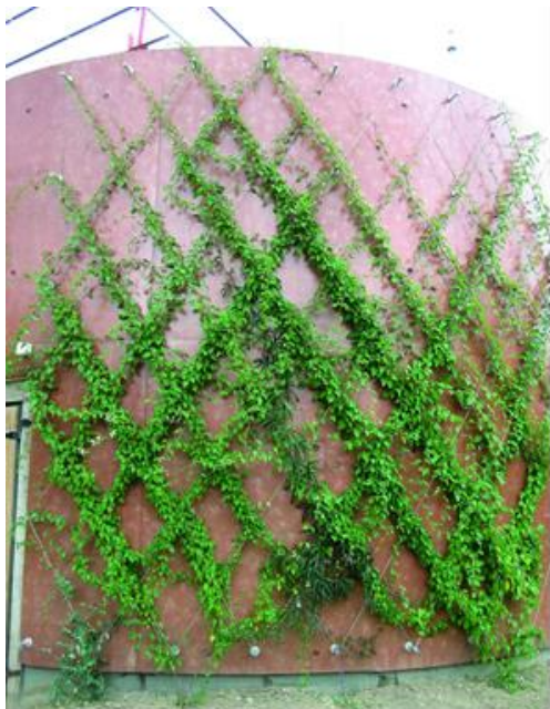
Obr. 25 Popínavé dřeviny na konstrukci
